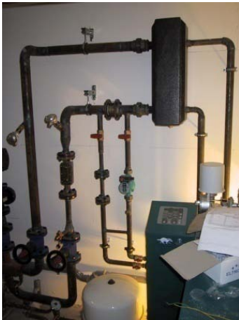
Електро- Тепло - блок (KWK)
