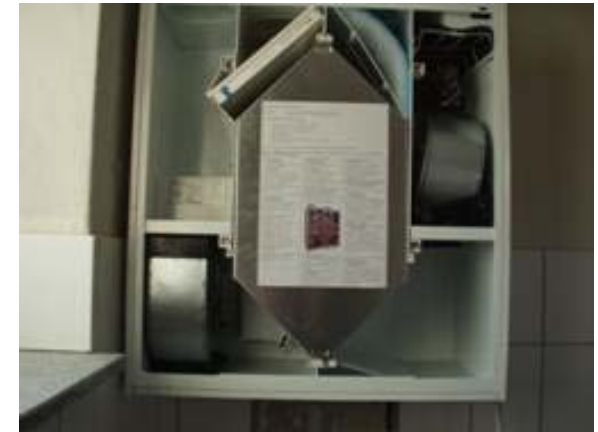
Вмонтована вентиляція з рекуперацією тепла
